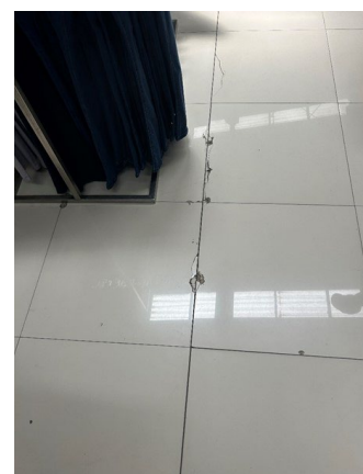
Vista interna pisos de porcelanato dañados en Tienda, dentro de Nave Industrial.
