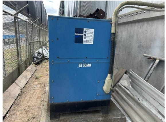
Vista de planta eléctrica.
