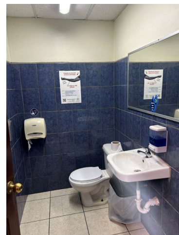
Vista interna de servicios sanitarios en mezzanine, dentro de nave industrial.
