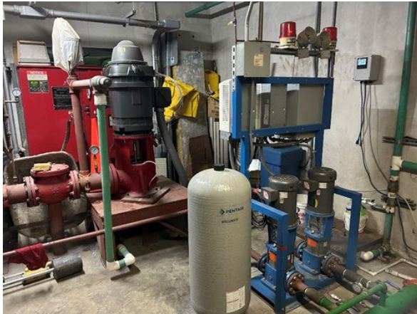
Sistema hidroneumático contraincendio.
