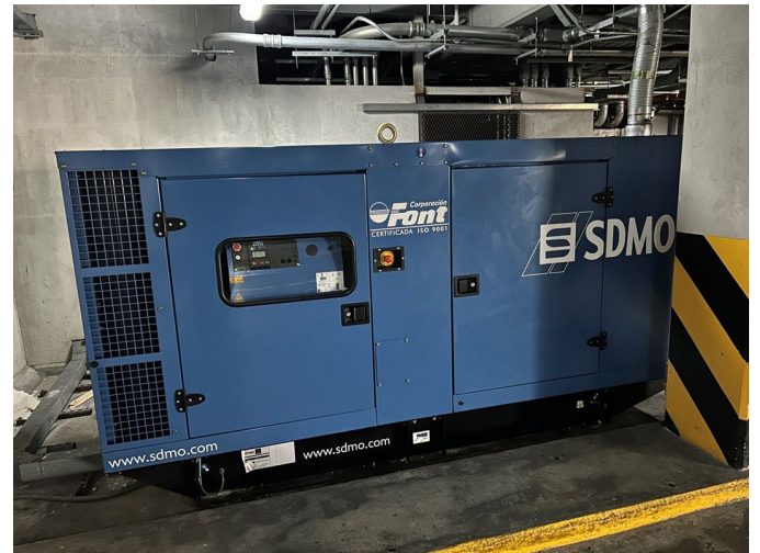
Planta eléctrica de áreas comunes.
