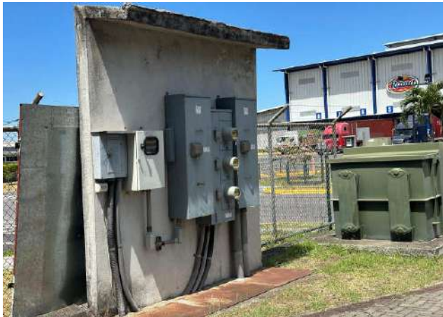
40-PANEL DE MEDIDORES
