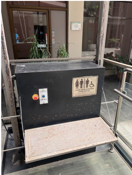
Elevador de carga y pasajeros ubicado en área común.
