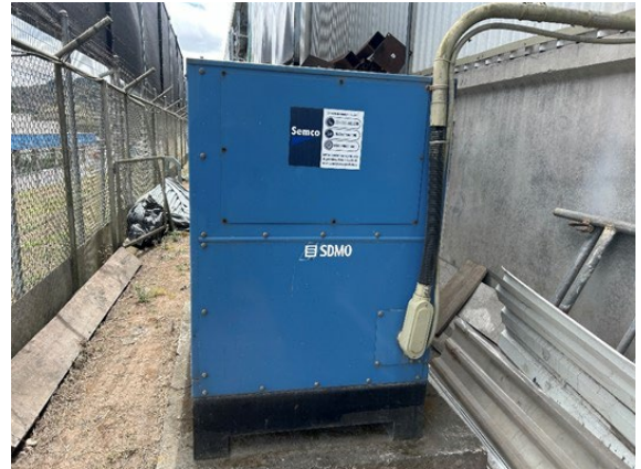
Vista de planta eléctrica.
