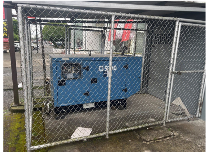
Vista interna de área de planta eléctrica.
