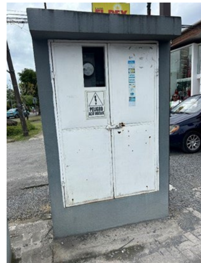
Vista de pedestal de medidor eléctrico y tableros principales.
