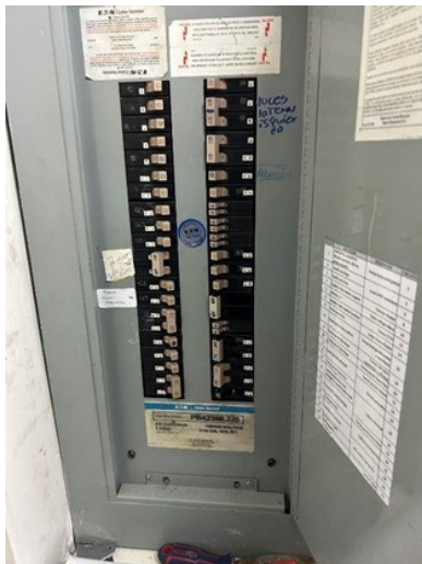
Vista de tableros eléctricos en aparente buen estado.
