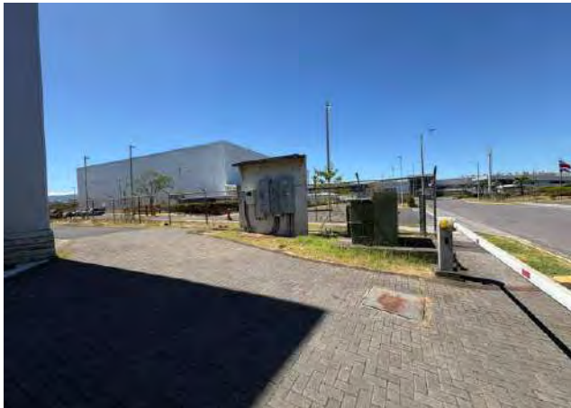
04 - Medidores y Trasnformador
